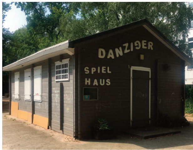
Das sanierungsbedürftige Danziger Spielhaus (Foto: Jana)
